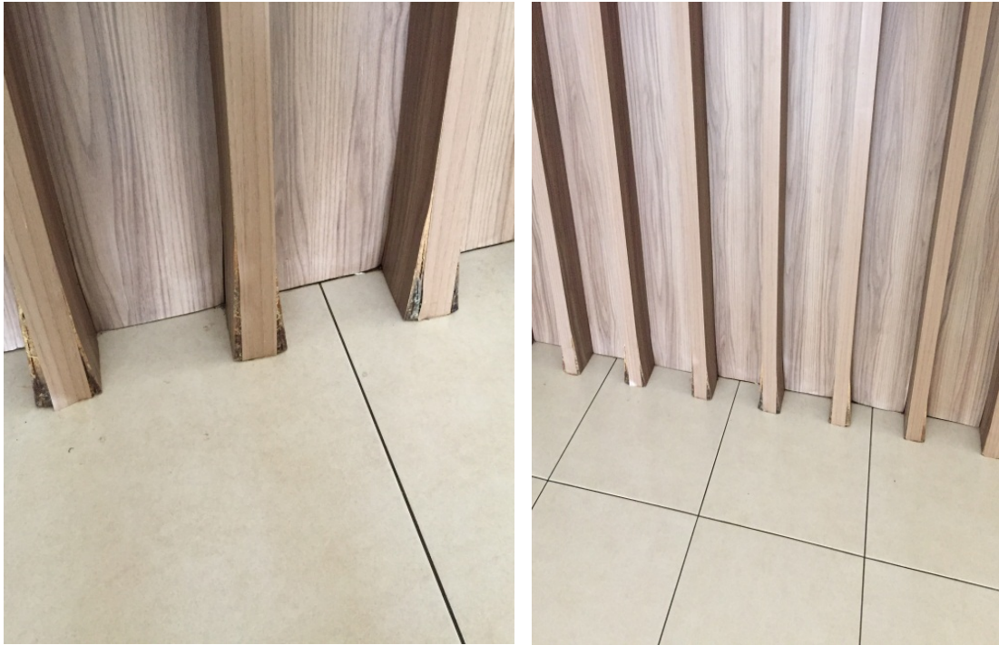
Painel de madeira danificado por água – salão de festas bloco D
