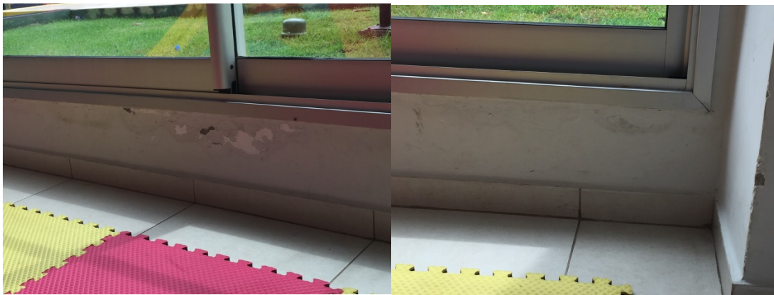
Indícios de infiltração na parede abaixo da janela da brinquedoteca
