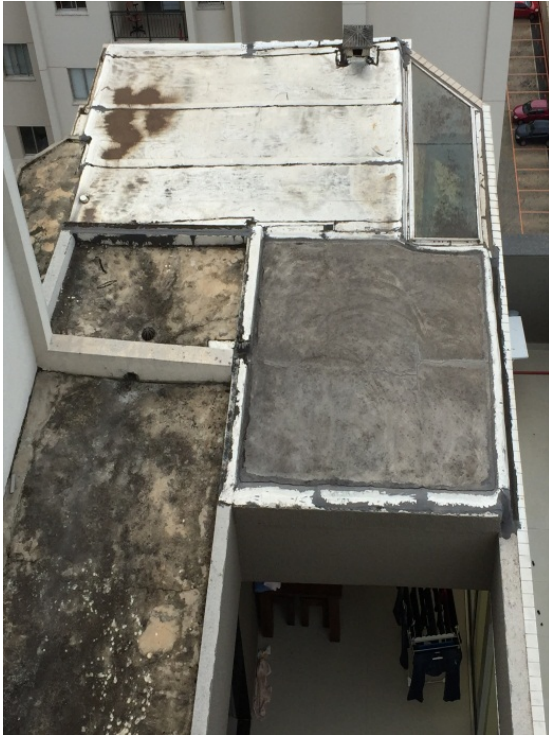
Fechamento de cobertura – alterado pelo proprietário – cobertura bloco C
