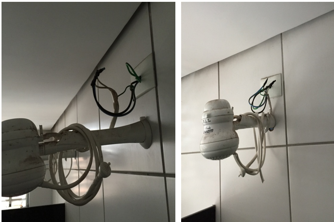
Fiação exposta na ligação do chuveiro do vestiário masculino
