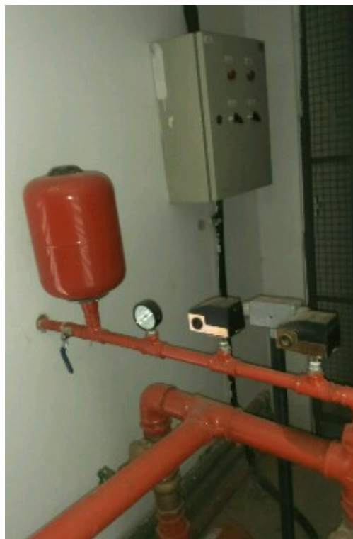
SISTEMAS DE PROTEÇÃO CONTRA INCÊNDIO – SISTEMA DE HIDRANTES DE PAREDE CONJUNTO DE BOMBAS DO BLOCO D, REDE TOTALMENTE DESPRESSURIZADA;
