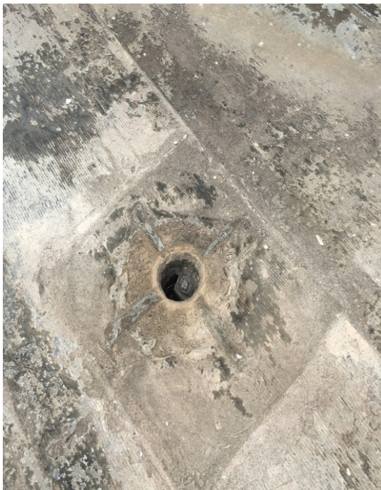
Ralo sem tampa na cobertura bloco D
