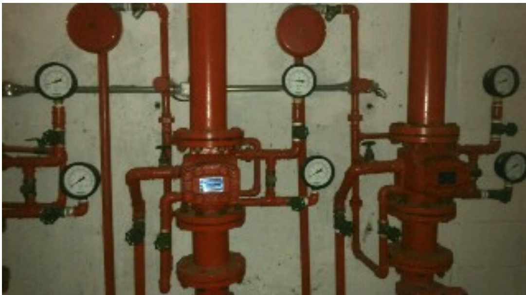
SISTEMAS DE PROTEÇÃO CONTRA INCÊNDIO – SISTEMA DE CHUVEIRO AUTOMÁTICO BARRILHETE DO SISTEMA DE SPRINKLER'S TOTALMENTE DESRESSURIZADO
