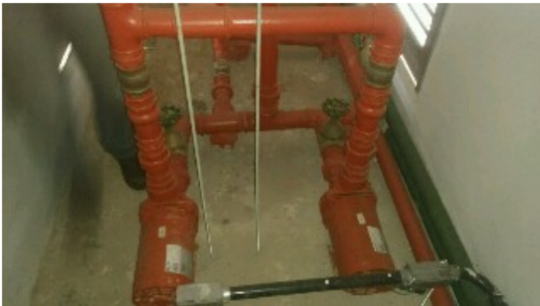
SISTEMAS DE PROTEÇÃO CONTRA INCÊNDIO – SISTEMA DE HIDRANTES DE PAREDE CONJUNTO DE BOMBAS DO BLOCO C, ACIONANDO AO MESMO TEMPO;
