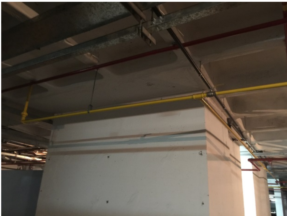
Tubulação de gás executada posterior a entrega, abaixo da padaria – área comercial
