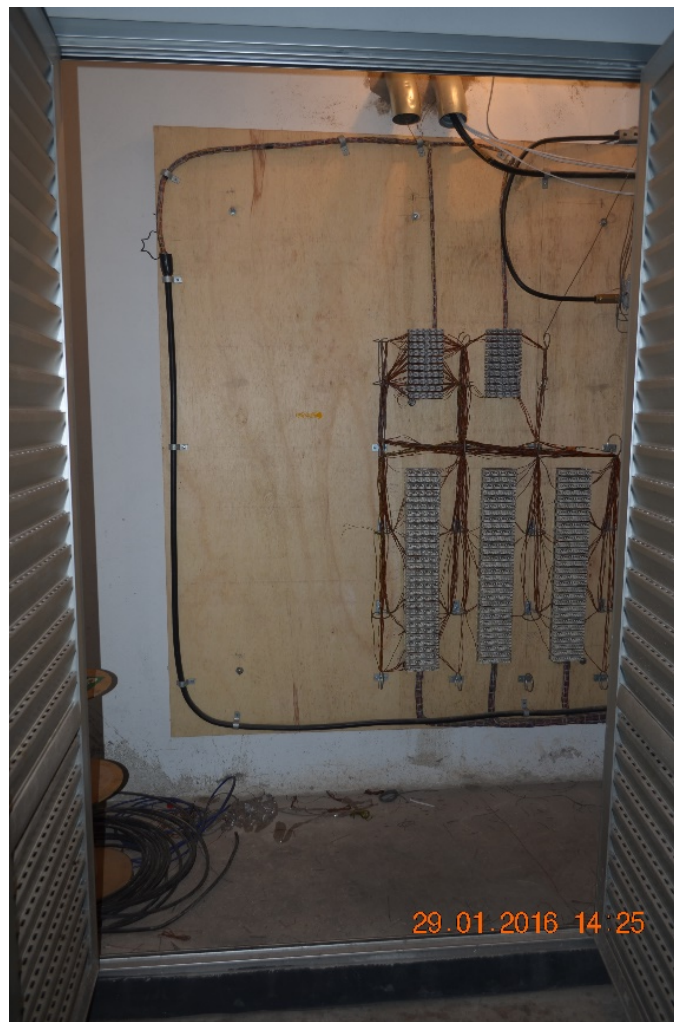
Quadro PRINCIPAL TELEFONIA – Subsolo – falta de identificação dos circuitos bem como de encaminhamento/organização adequados.
