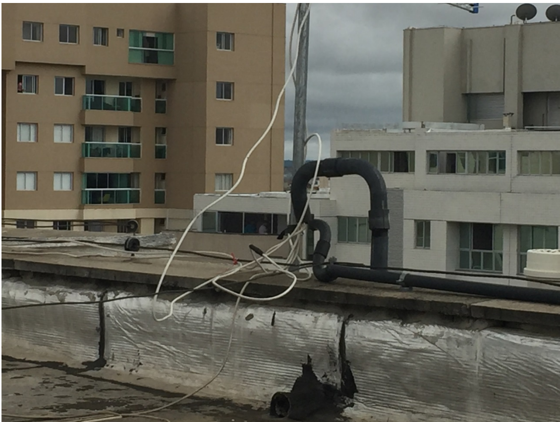
Antenas coletivas instaladas posterior a entrega e danificando a tubulação de tv – bloco C
