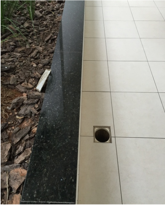
Ralo sem acabamento no Pilotis bloco B
