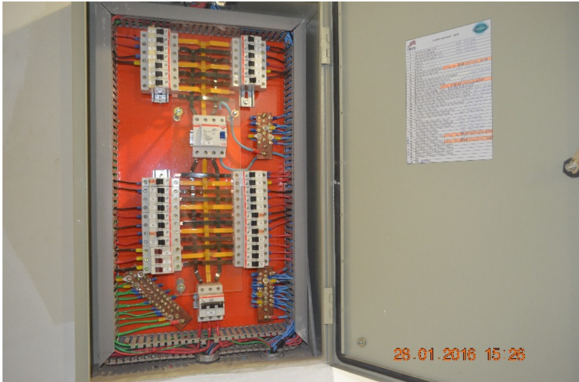
Quadro iluminação com identificação dos circuitos adulterada- QL bloco A
