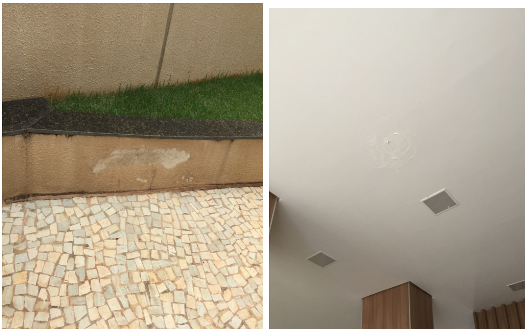
Mureta atrás do playground descascando pintura
