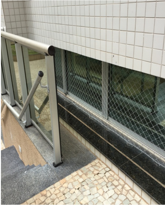
Furo sem calafetação na fachada na instalação de tela de proteção – salão de festas bloco D
