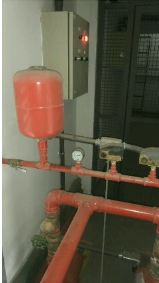
SISTEMAS DE PROTEÇÃO CONTRA INCÊNDIO – SISTEMA DE HIDRANTES DE PAREDE CONJUNTO DE BOMBAS DO BLOCO A COM PRESSÃO ELEVADA, 7,5 kgf/cm 2 .
