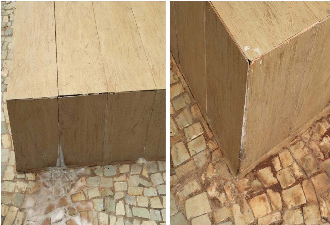
Bancos do playground com pontos de eflorescência
