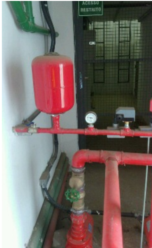
SISTEMAS DE PROTEÇÃO CONTRA INCÊNDIO – SISTEMA DE HIDRANTES DE PAREDE CONJUNTO DE BOMBAS DO BLOCO B, FIAÇÃO EXPOSTA PROXIMO A JUNÇÃO ELÉTRICA DAS BOMBAS E OS CONDULETES;
