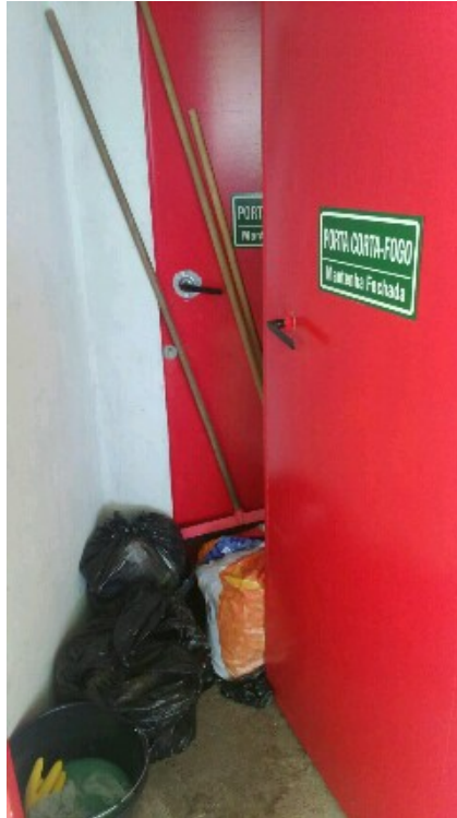
SISTEMAS DE PROTEÇÃO CONTRA INCÊNDIO – PORTAS CORTA FOGO SAÍDA DE EMERGÊNCIA OBSTRUÍDA ( BLOCO B).
