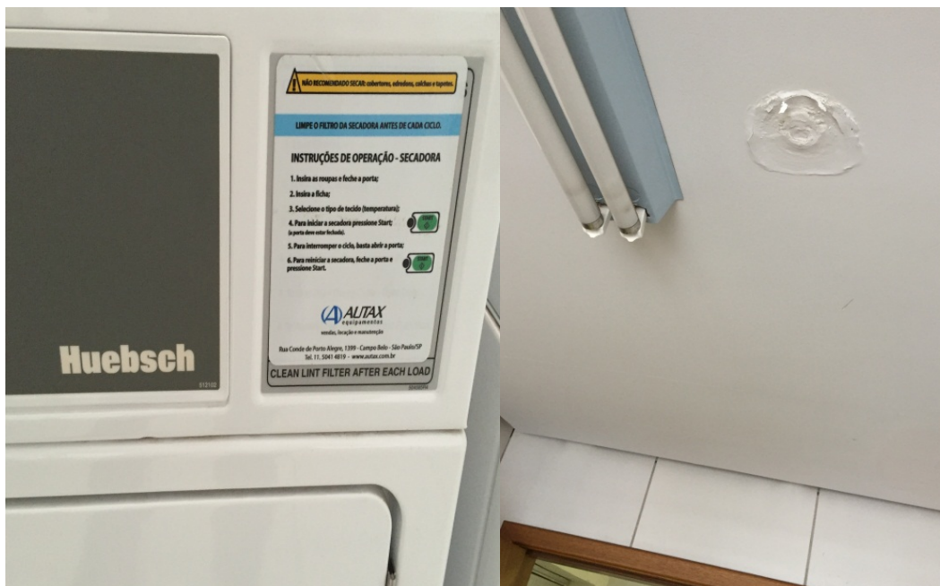
Indício de infiltração no forro de gesso da lavanderia
