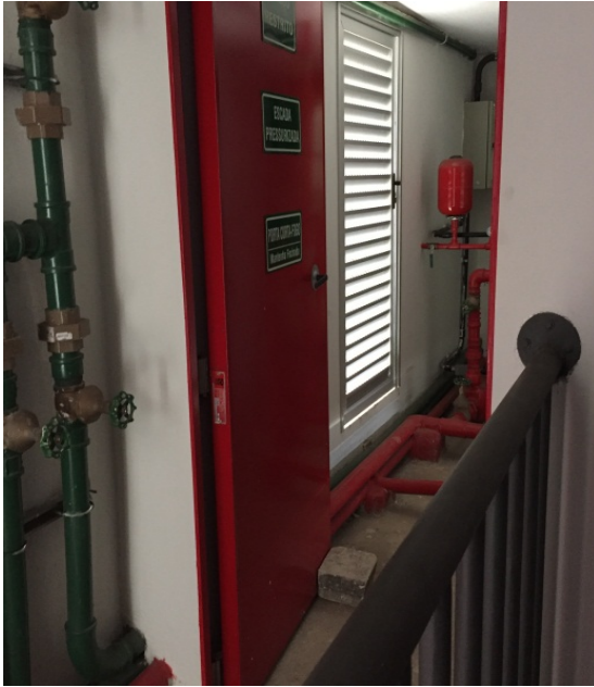
Porta corta fogo mantida aberta de – cobertura bloco D
