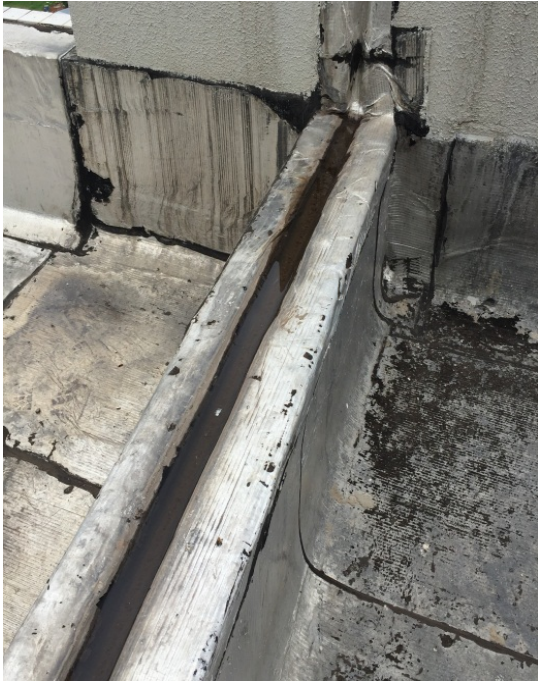
Acumulo de água – cobertura bloco D
