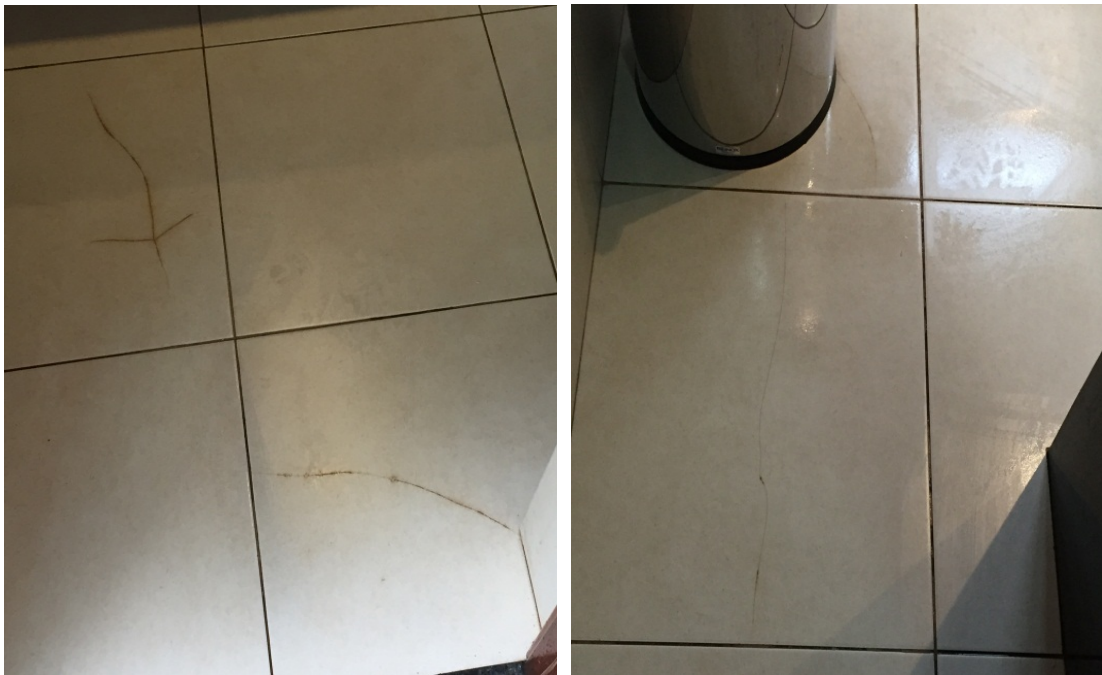
Banheiro feminino da churrasqueira possui peças cerâmicas trincadas e ausência de rejunte
