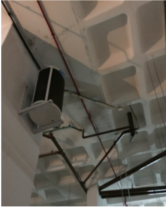
Aparelho de ar condicionado instalado no 1º subsolo – abaixo do bloco D
