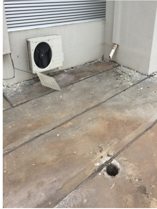
Instalação de ar condicionado e ralo sem tampa cobertura bloco D
