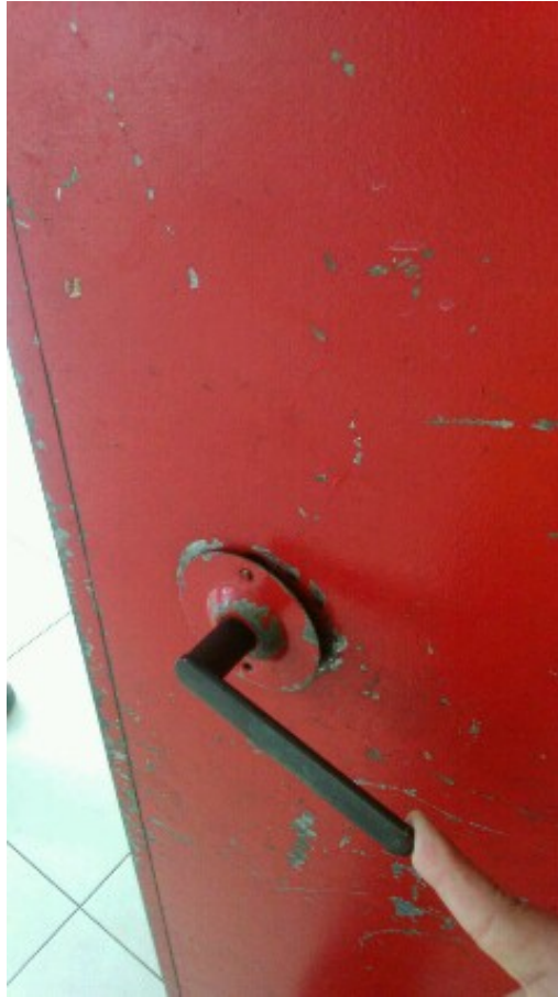
SISTEMAS DE PROTEÇÃO CONTRA INCÊNDIO –PORTAS CORTA FOGO PORTAS CORTA FOGO COM MAÇANETAS E DOBRADIÇAS DANIFICADAS, FALTA DE MANUTENÇÃO.
