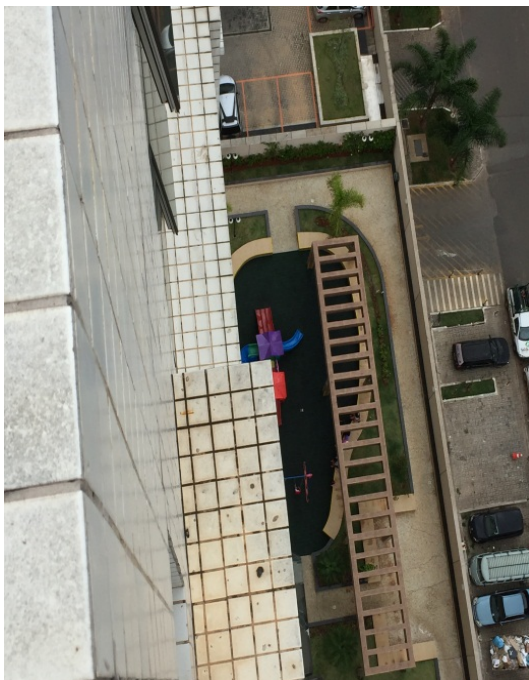
Falha de rejunte – fachada bloco C
