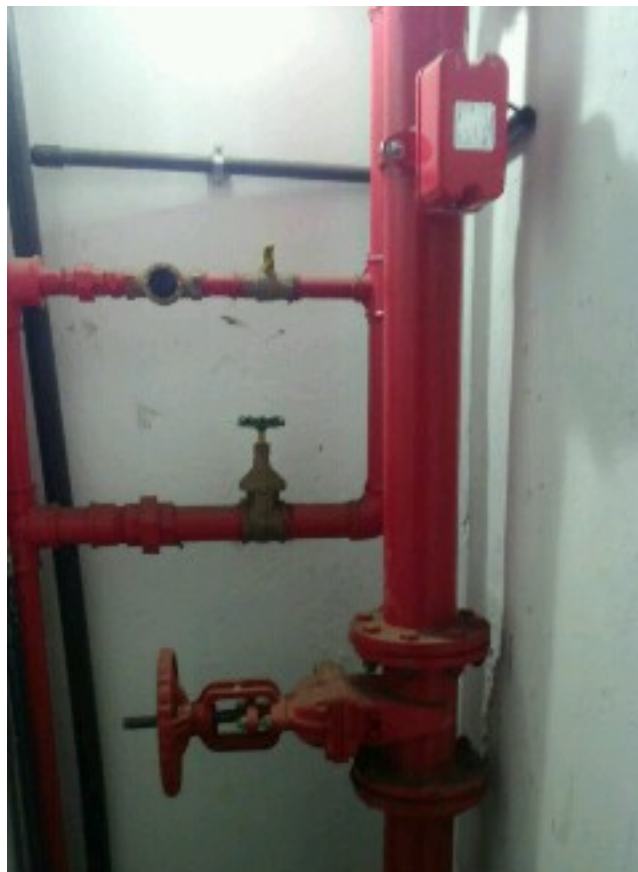
SISTEMAS DE PROTEÇÃO CONTRA INCÊNDIO – OUTROS ITENS DE INCONFORMIDADE À NORMA VALVULA DE GOVERNO AUTOMÁTICA, REGISTRO FECHADO, SEM MANUTENÇÃO.
