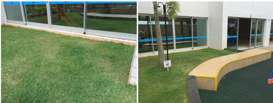
Jardim do lado de fora da parede da brinquedoteca que apresenta indícios de umidade
