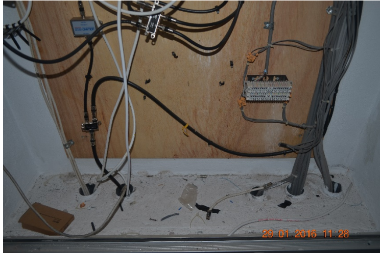
Caixa CFTV/TELEFONIA – 2º andar do Bloco C-2 com cabos sem identificação ou encaminhamento adequado.
