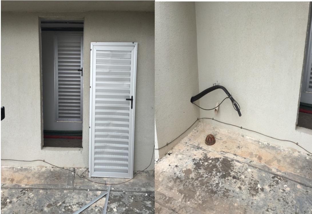
Sem porta de acesso a cobertura do bloco D
