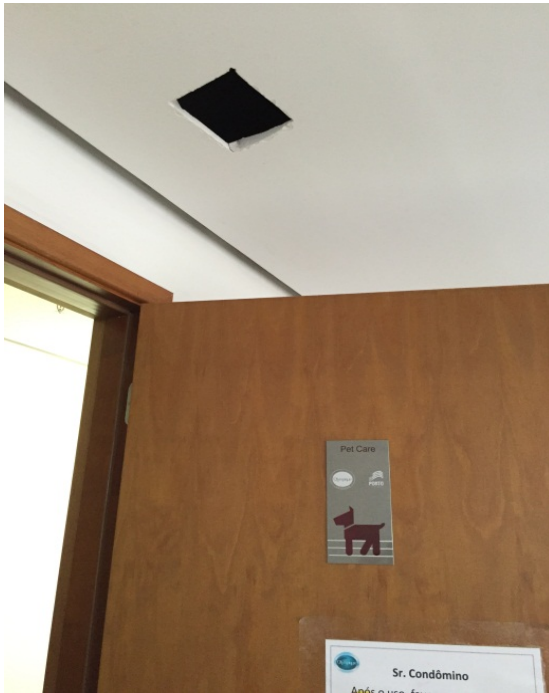
Forro com buraco no Pet Care
