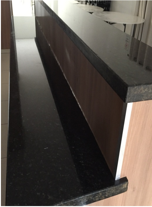
Painel madeira danificado no salão de festas bloco C
