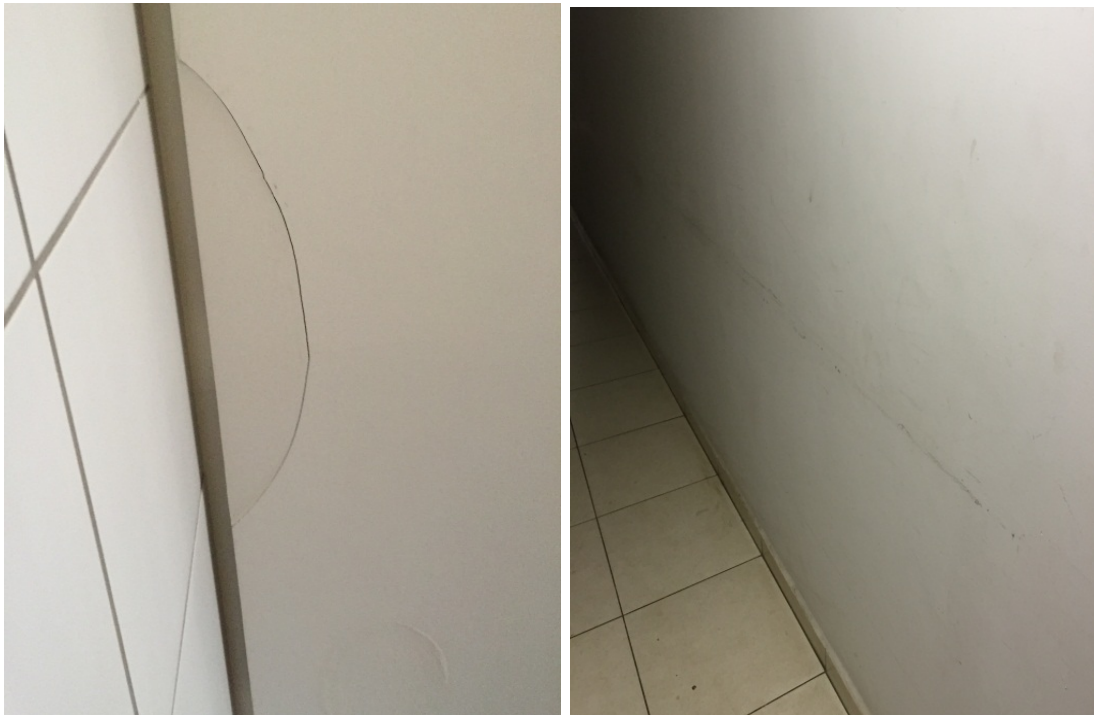
Teto e parede danificada no vestiário masculino
