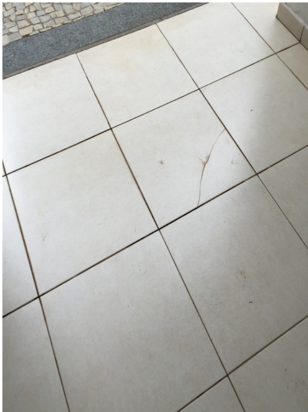
Piso em frente guarita do térreo - trincas
