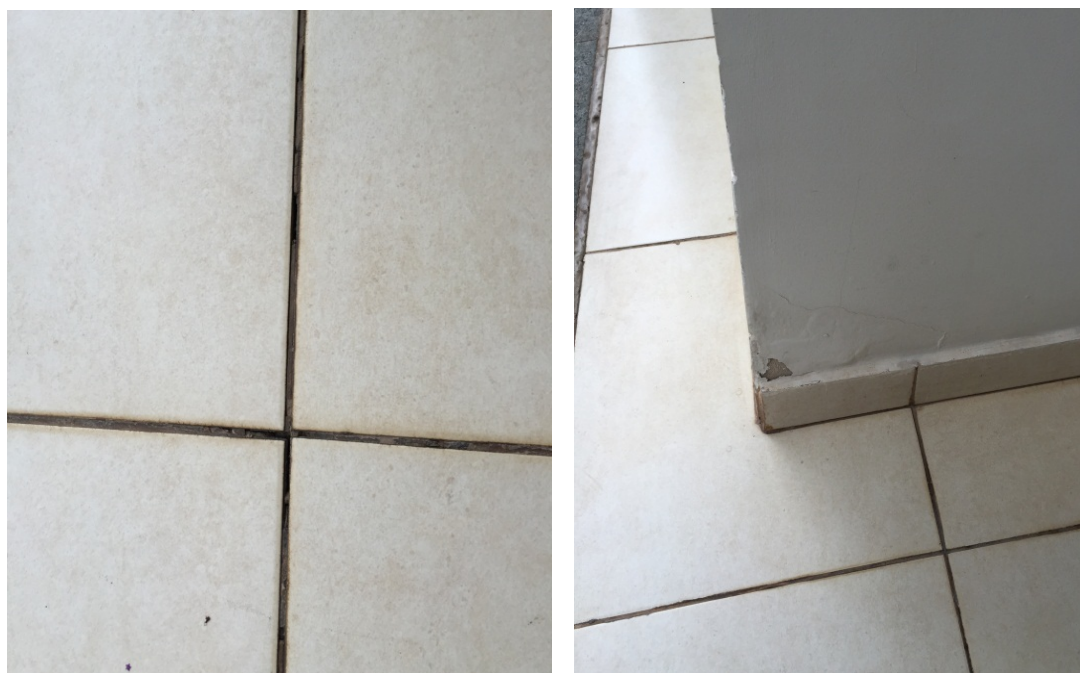
Piso sem rejunte e parede quebrada em frente guarita do térreo
