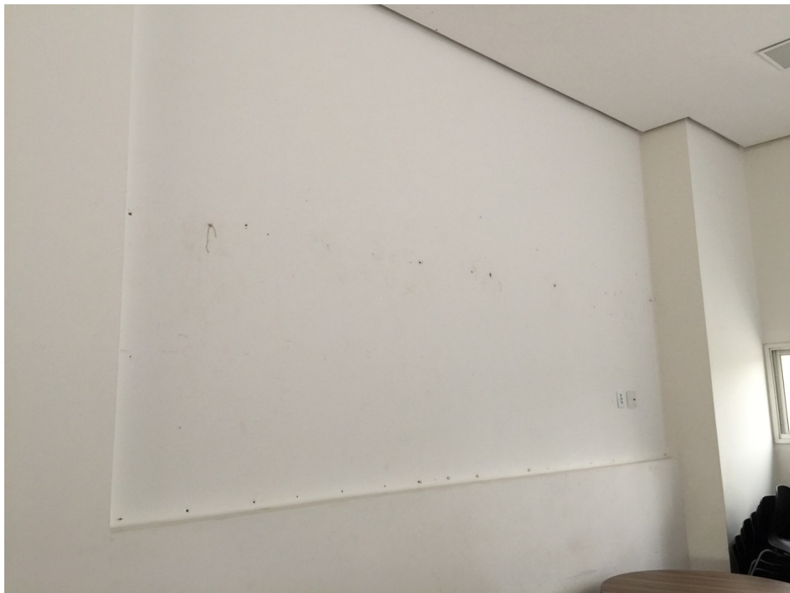
Parede danificada salão de festas D
