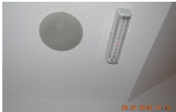
Sensor não funciona - Escada entre 12º e 11º B Bloco B.
