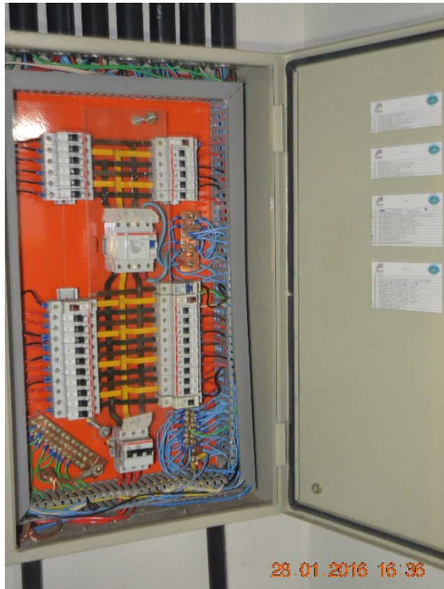
Quadro de Iluminação do Bloco C
