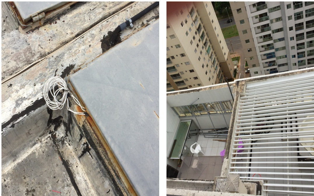
Fiação elétrica exposta e manta de impermeabilização – furada com fixação do cabeamento das antenas de tv a cabo – Cobertura alterada pelo proprietário após entrega – bloco D
