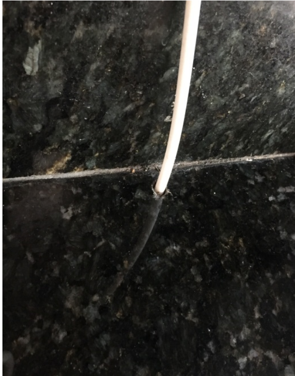
Furo na bancada pra instalação do filtro, sem vedação – salão de festas bloco D
