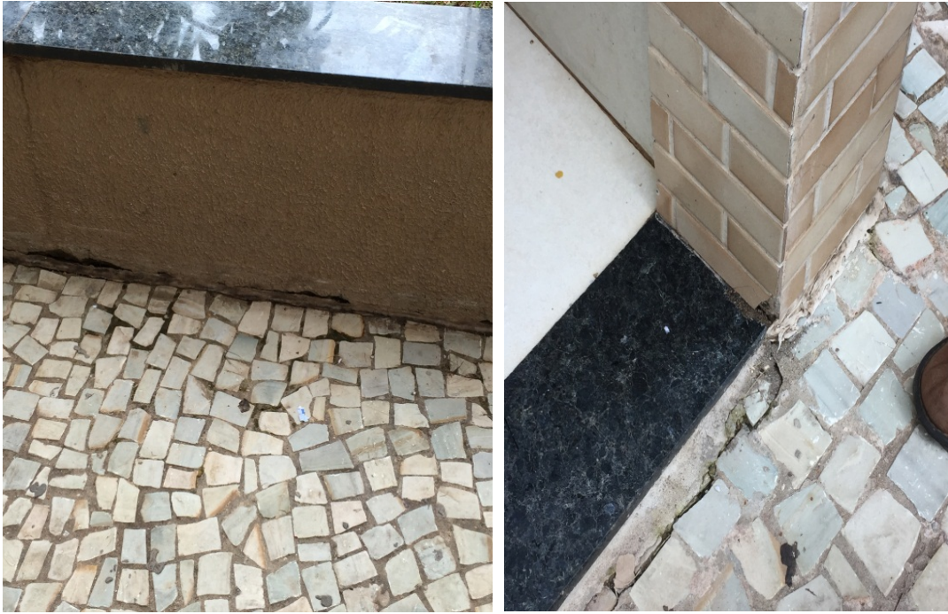
Trinca na base da mureta e no piso, próximo as churrasqueiras
