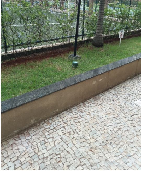
Pintura danificada na mureta área comum
