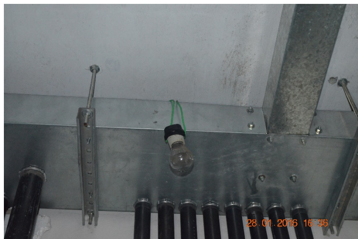
Fiação exposta - Barramento Bloco C
