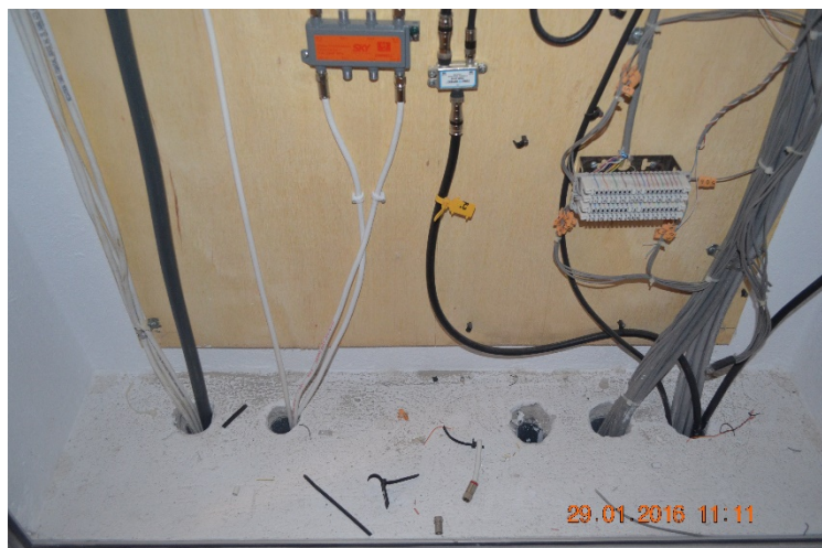
Caixa CFTV/TELEFONIA – 5º andar do Bloco C-2 com cabos sem identificação ou encaminhamento adequado.
