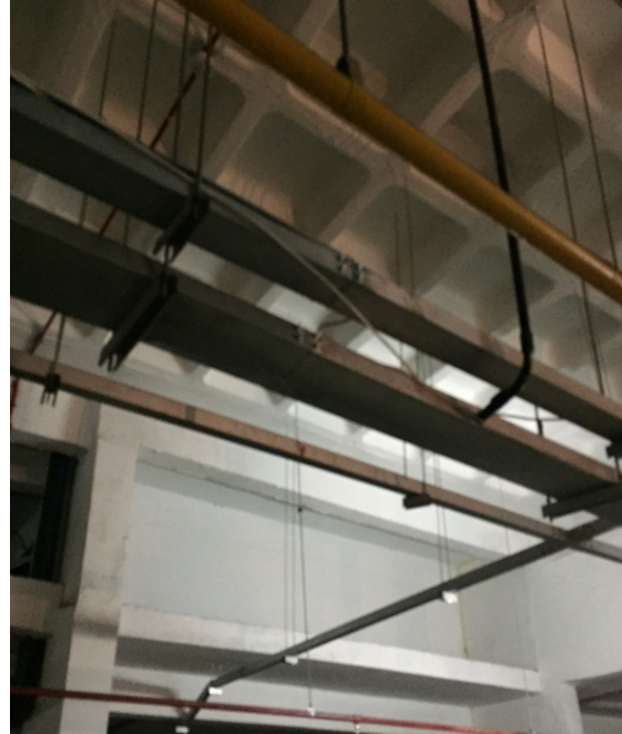
Cabeamento fora da eletrocalha – 1º subsolo bloco D
