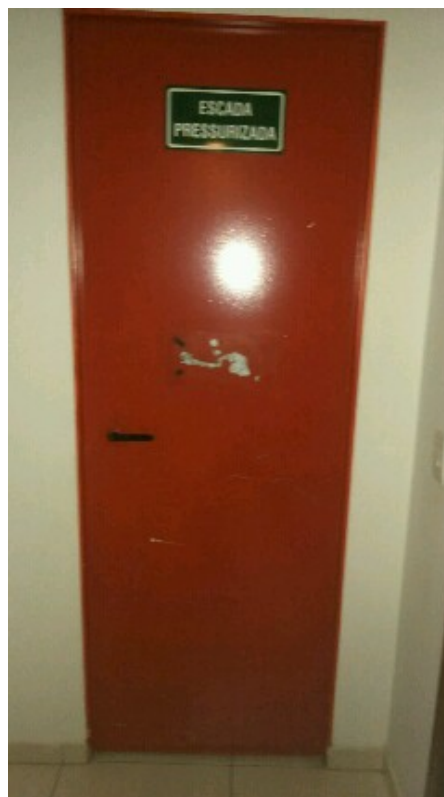
SISTEMAS DE PROTEÇÃO CONTRA INCÊNDIO – PORTAS CORTA FOGO PORTA DE EMERGÊNCIA COM A SINALIZAÇÃO IMCOMPLETA. (BLOCO C).
