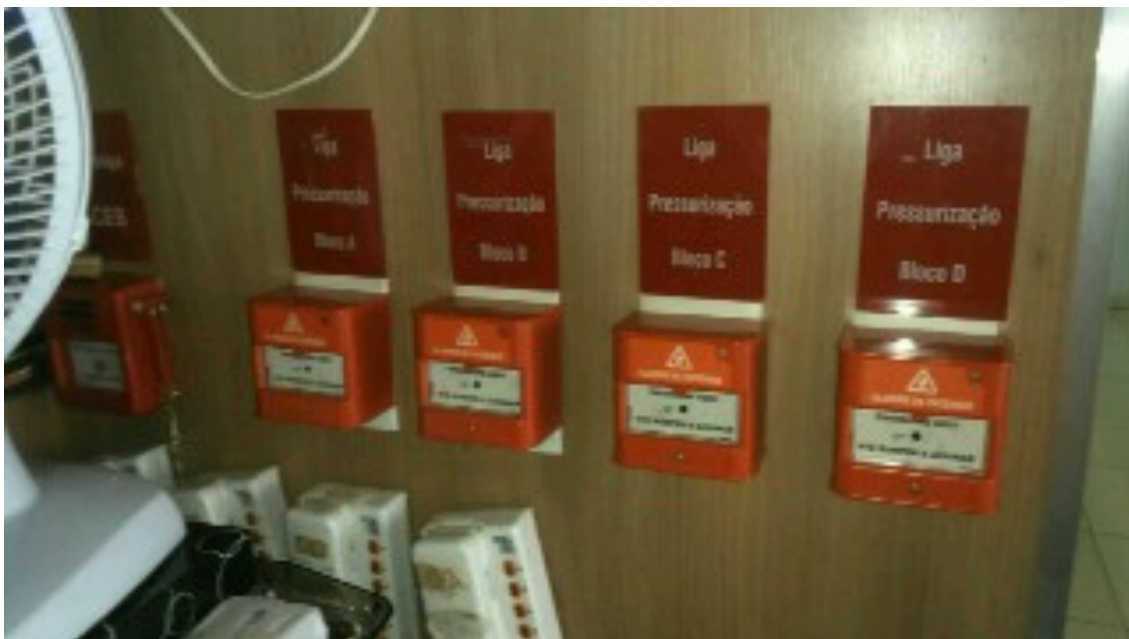
SISTEMAS DE PROTEÇÃO CONTRA INCÊNDIO - CENTRAL DE DETECÇÃO E ALARMES SISTEMA DE AUTOMAÇÃO DO GRUPO PRESSURIZADOR DAS ESCADAS INOPERANTE.
