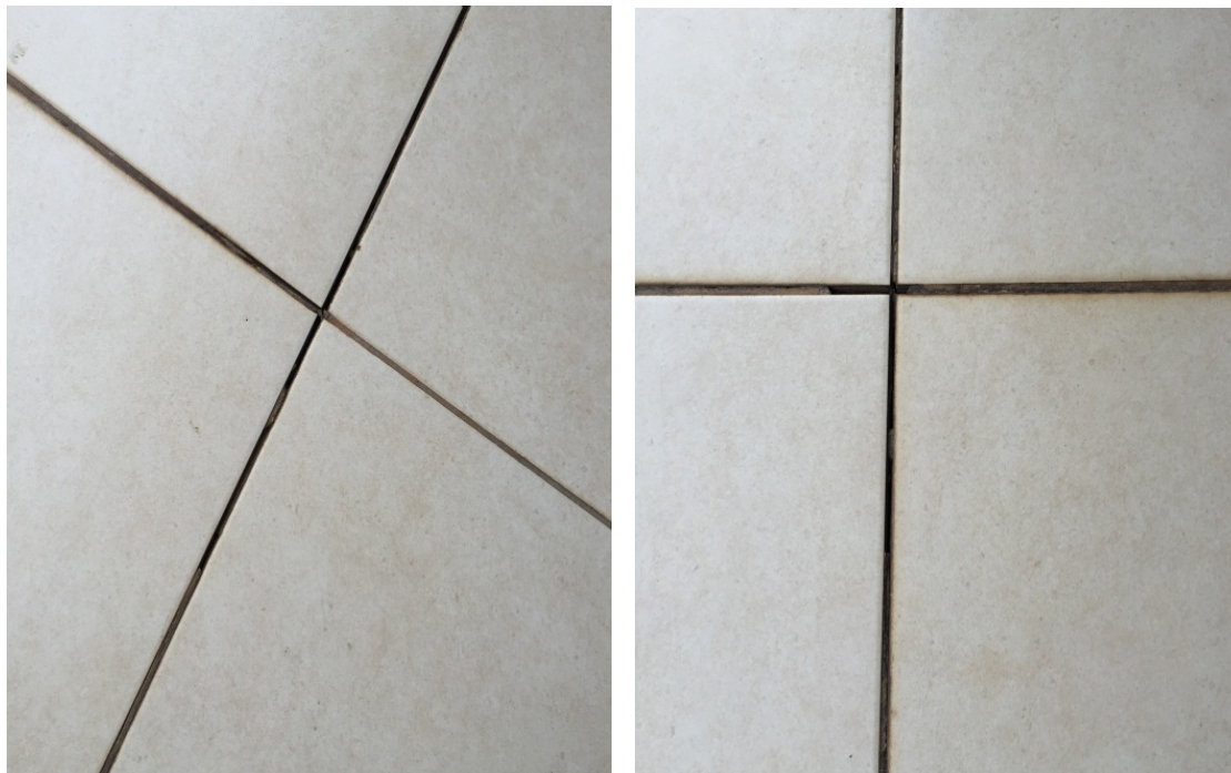
Piso em frente guarita do térreo – falha rejunte
