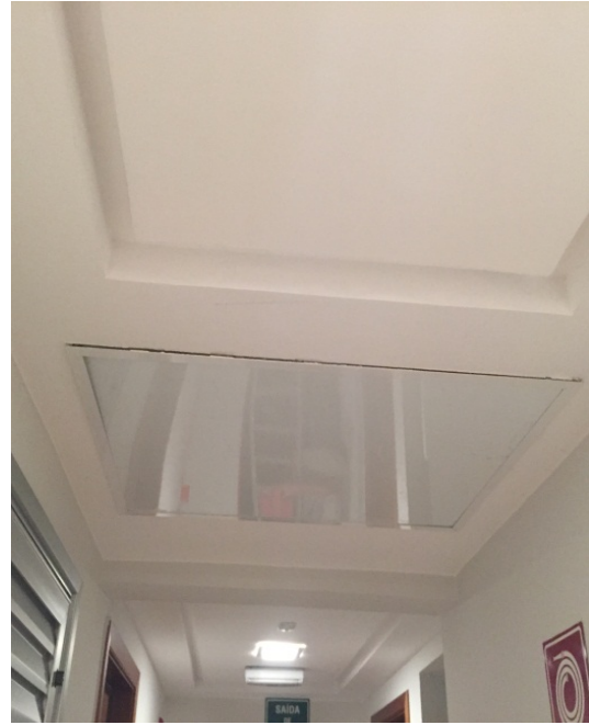
Contramarco da visita à válvula redutora de pressão soltando – bloco D
