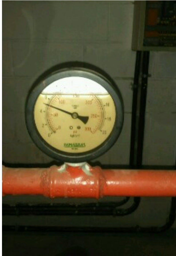
SISTEMAS DE PROTEÇÃO CONTRA INCÊNDIO – SISTEMA DE CHUVEIRO AUTOMÁTICO REDE COMPLETAMENTE DESPRESSURIZADA; INFILTRAÇÕES NOS MANÔMETROS
