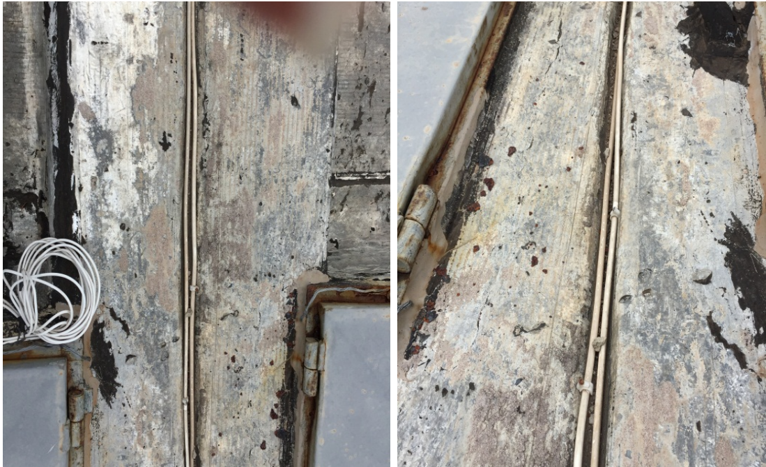
Danos na manta de impermeabilização – furada com fixação do cabeamento das antenas de empresas como SKY, CLARO-OI – cobertura bloco D
