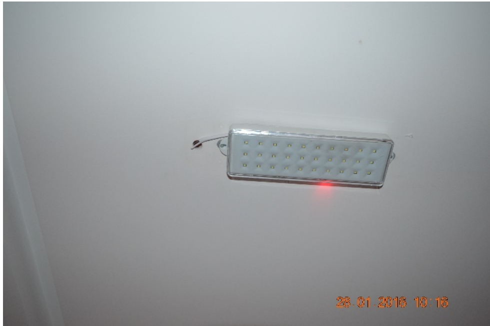
Luzes de emergência 17º B não funcionam e fiação exposta em frente ao Ap 1705 B
