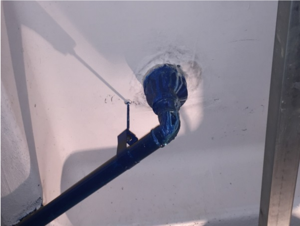
Ponto de infiltração próximo a rampa de veículo interdita no 1º. Sub solo
