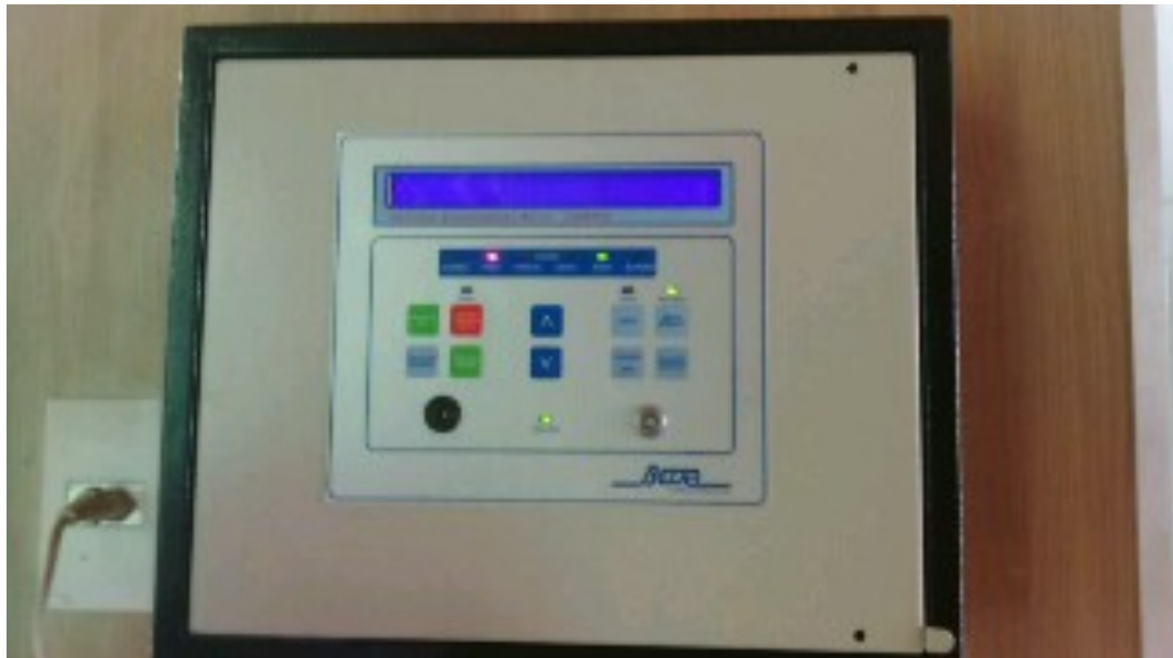
SISTEMAS DE PROTEÇÃO CONTRA INCÊNDIO - CENTRAL DE DETECÇÃO E ALARMES CENTRAL DE ALARMES E DETECÇÃO DESLIGADA.
