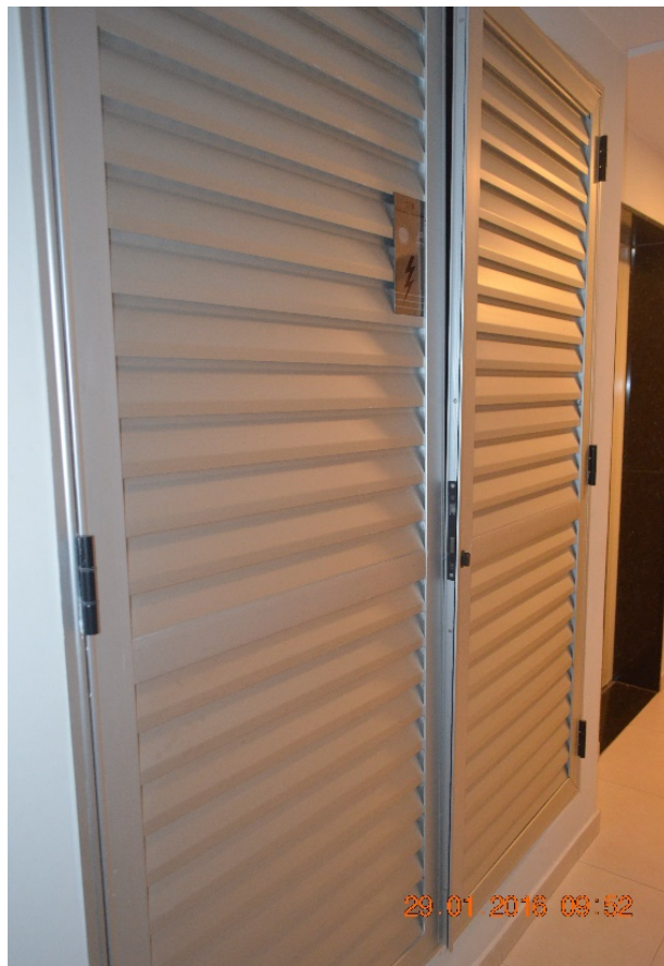
Porta de quadro de medição CEB 17C2 emperrada.
