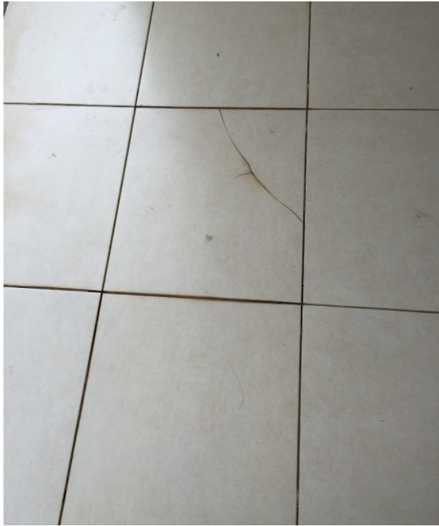
Piso em frente guarita do térreo - trincas
