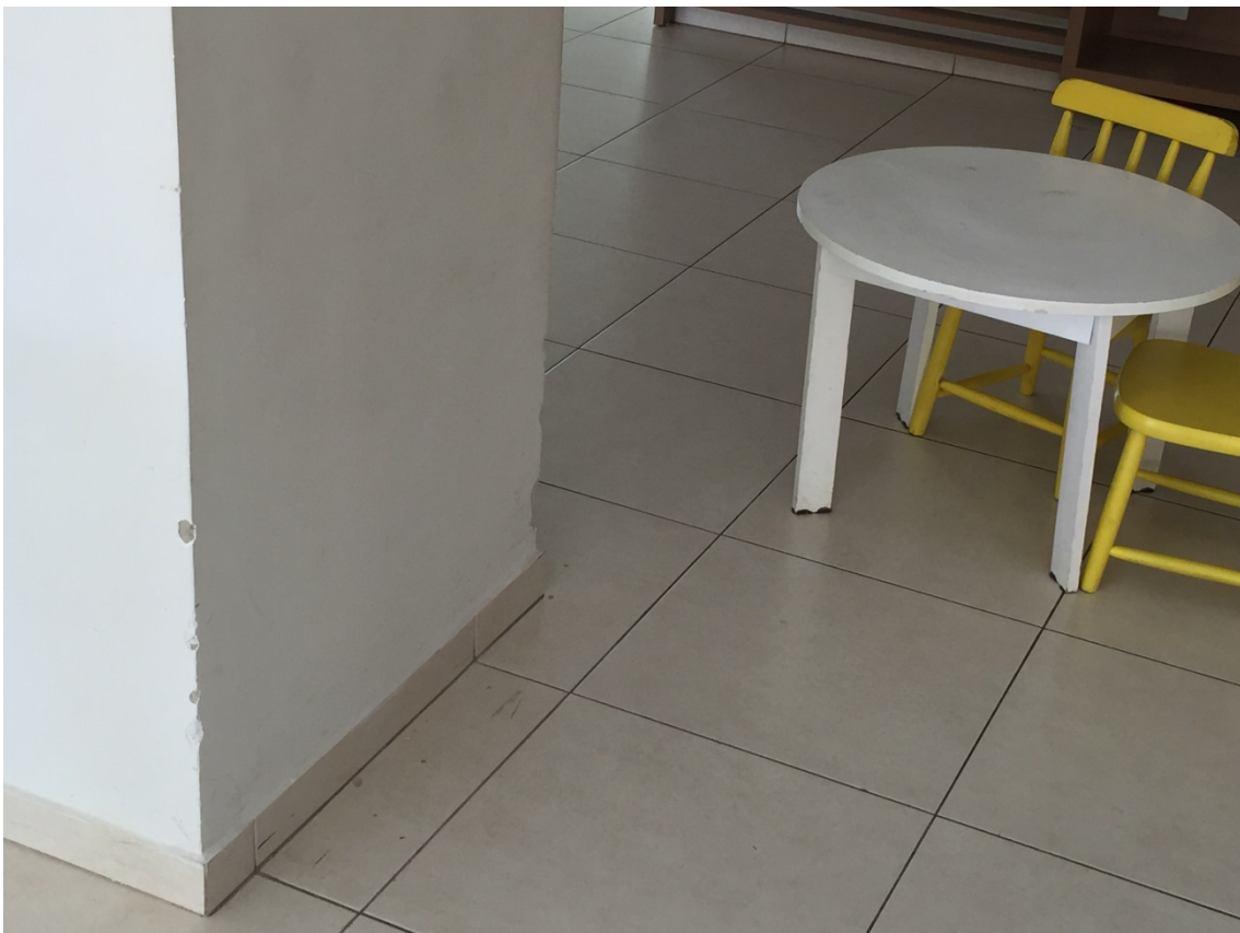
Acabamentos das quinas dos pilares danificados na brinquedoteca
