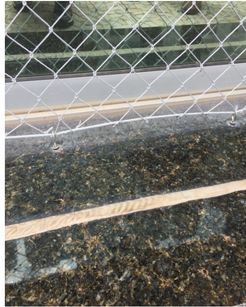
Furo sem calafetação na fachada na instalação tela de proteção – salão de festas bloco D
