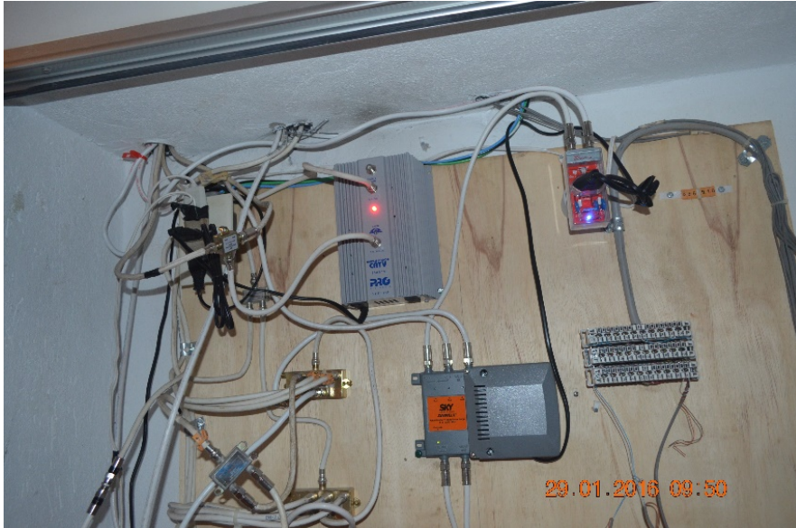
Caixa CFTV/TELEFONIA – 17º andar do Bloco C-1 com cabos sem identificação ou encaminhamento adequado.
