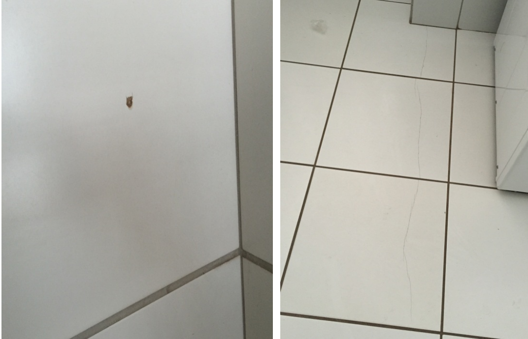
Peça cerâmica danificada e Trinca no piso da lavanderia
