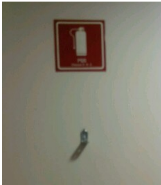
SISTEMAS DE PROTEÇÃO CONTRA INCÊNDIO – PROTEÇÃO POR EXTINTORES FALTA DE EXTINTORES. (BLOCO A)
