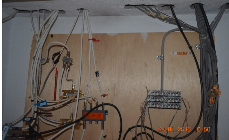
Caixa CFTV/TELEFONIA – 8º andar do Bloco C-2 com cabos sem identificação ou encaminhamento adequado.
