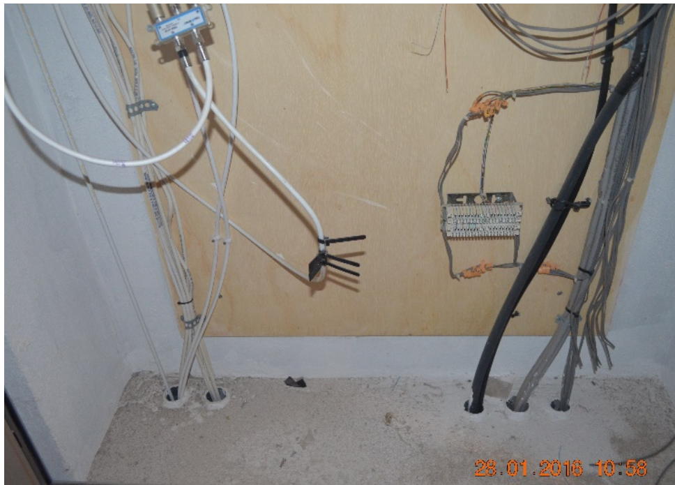
Caixa CFTV/TELEFONIA - 15º andar do Bloco B com cabos sem identificação ou encaminhamento adequado.
