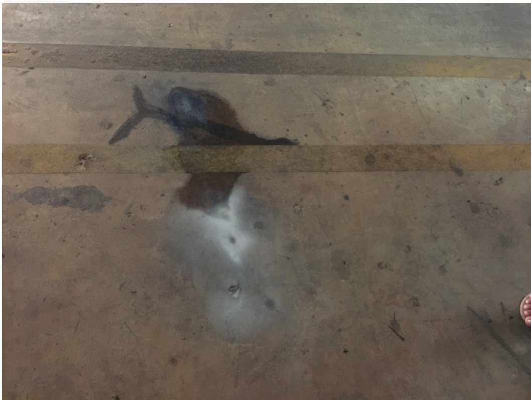
Ponto de infiltração próximo a rampa de veículo interdita no 1º. Sub solo
