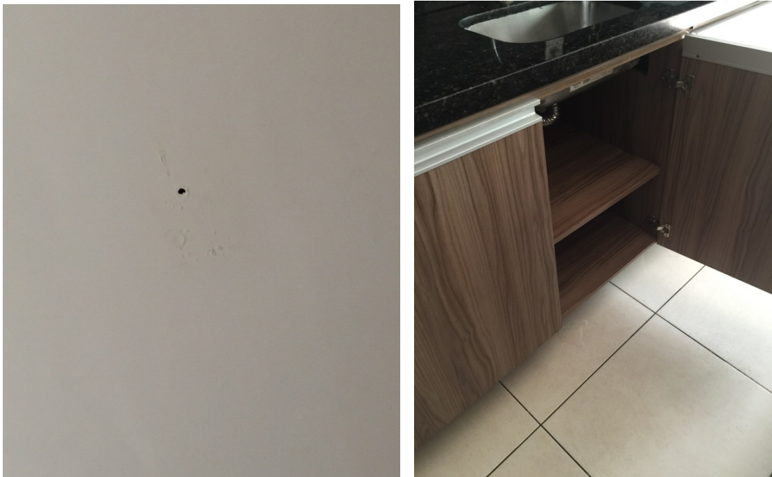
Sinal de infiltração no forro e na pia no salão de festas bloco D
