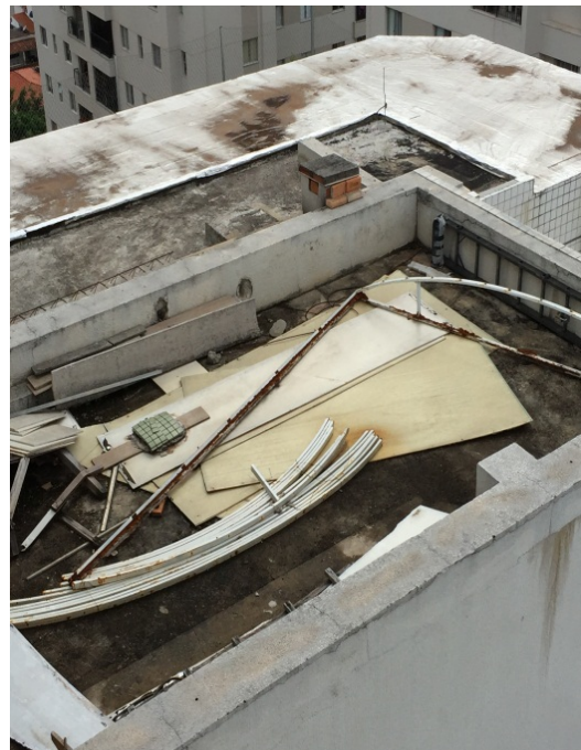
Acumulo de entulho – cobertura bloco C
