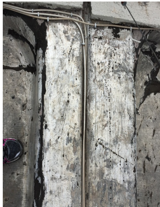
Danos na manta de impermeabilização – furada com fixação do cabeamento das antenas de empresas como SKY, CLARO-OI
