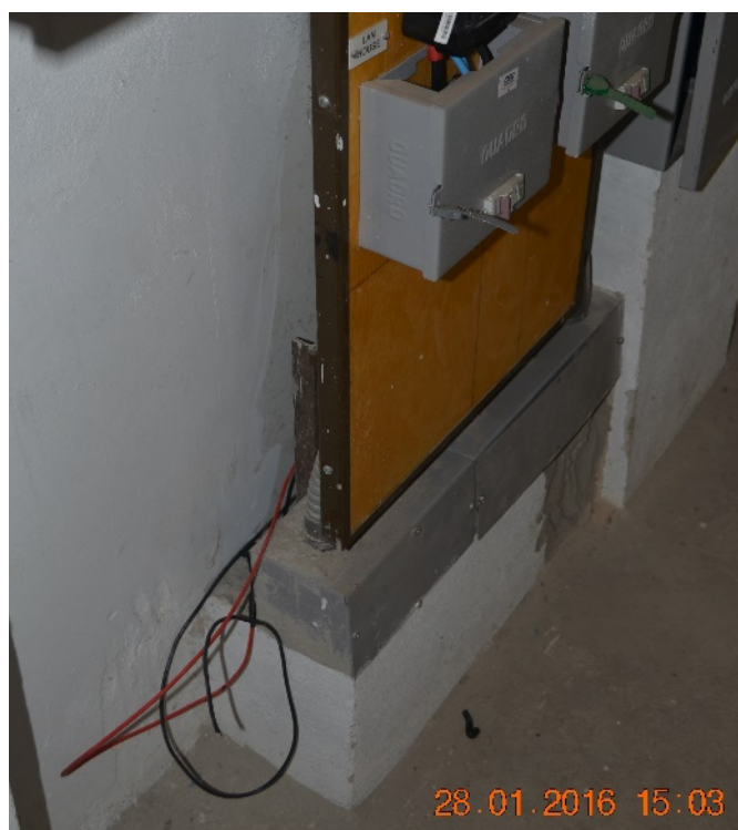
Fiação exposta sala da CEB
