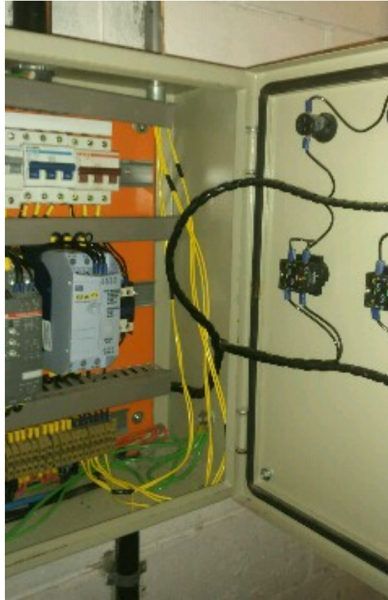
SISTEMAS DE PROTEÇÃO CONTRA INCÊNDIO – SISTEMA DE CHUVEIRO AUTOMÁTICO QUADRO DE COMANDO DO SISTEMA DE SPRINKLER'S DESLIGADO
