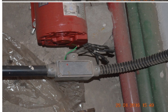
Fiação exposta (após aparente intervenção para manutenção) - Casa de máquinas Bloco C
