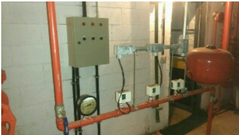
SISTEMAS DE PROTEÇÃO CONTRA INCÊNDIO – SISTEMA DE CHUVEIRO AUTOMÁTICO SISSTEMA COM VAZAMENTO NAS JUNTAS E UNIÕES; TOTALMENTE INOPERANTE
