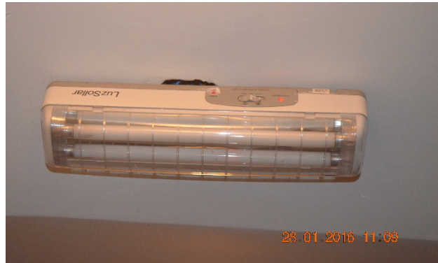
Fiação exposta - Escada entre 13º e 12º do Bloco B.
