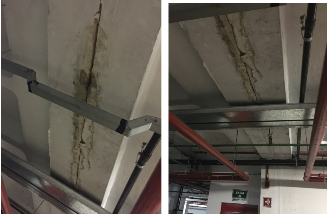
Junta de dilatação com vazamento proveniente do pilotis
