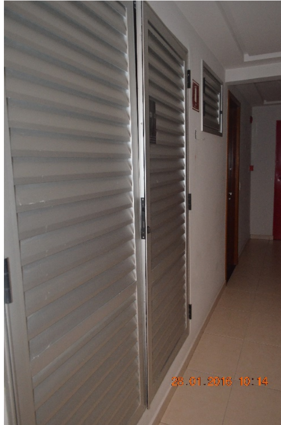
Porta de quadro de medição da CEB - 17B2 emperrado na parte inferior
