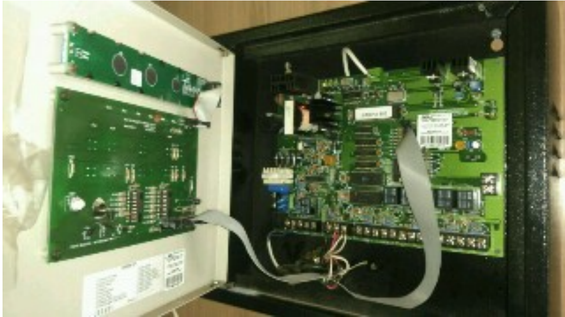
SISTEMAS DE PROTEÇÃO CONTRA INCÊNDIO - CENTRAL DE DETECÇÃO E ALARMES CENTRAL INOPERANTE PARA TODOS OS SISTEMAS DE DETECÇÃO.
