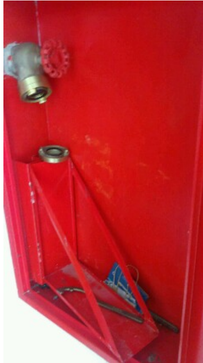
SISTEMAS DE PROTEÇÃO CONTRA INCÊNDIO – SISTEMA DE HIDRANTES DE PAREDE (HIDRANTE DE PAREDE DO BLOCO C) FALTA DE EQUIPAMENTOS DOS HIDRANTES DE PAREDE, TAIS COMO MANGUEIRAS E ESGUINCHOS;
