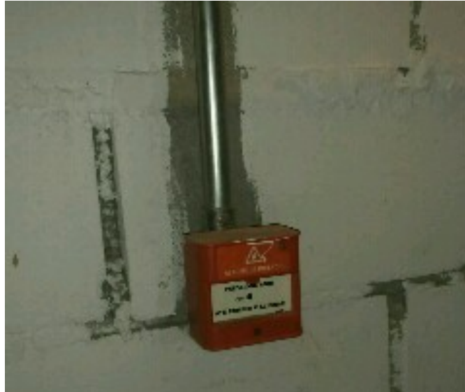
SISTEMAS DE PROTEÇÃO CONTRA INCÊNDIO – OUTROS ITENS DE INCONFORMIDADE À NORMA ACIONADOR MANUAL DANIFICADO. (CASA DE BOMBAS 2º SUBSOLO).
