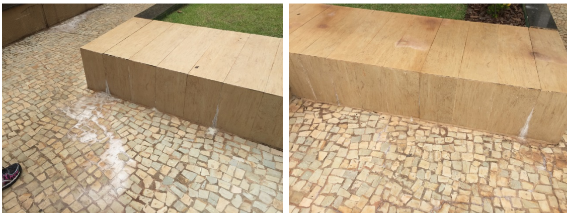
Bancos do playground com pontos de eflorescência
