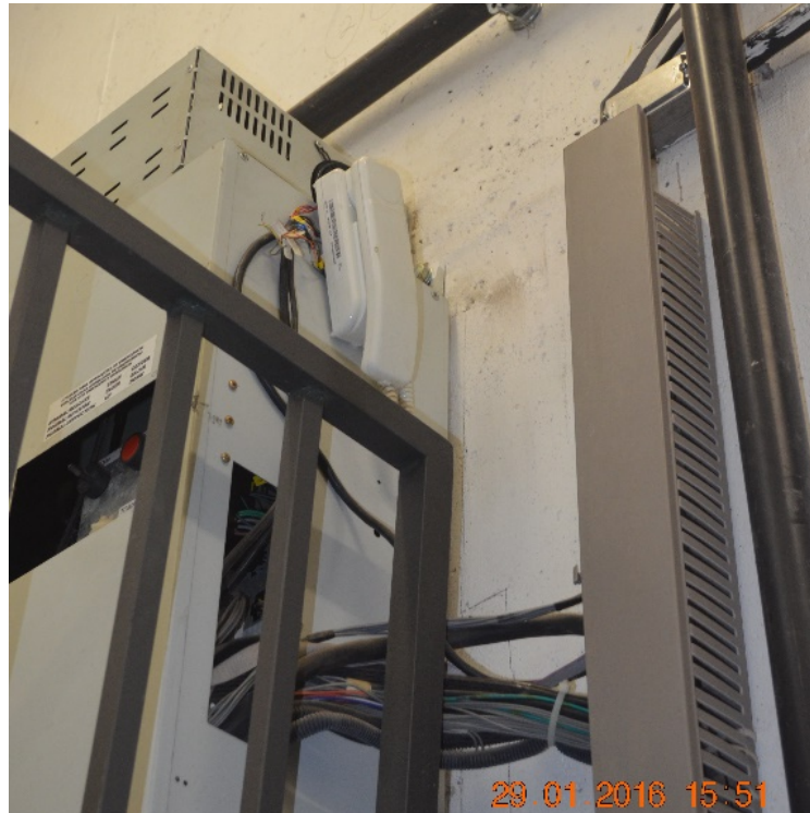
Fiação exposta (após aparente intervenção para manutenção) - Casa de máquinas Bloco C
