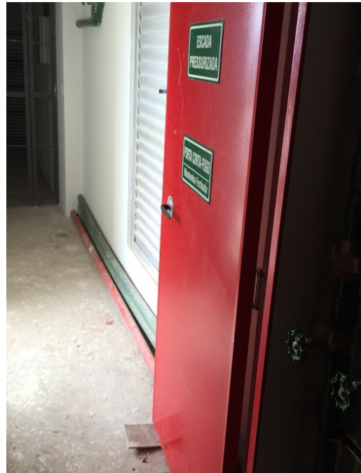
Porta corta fogo mantida aberta cobertura bloco D
