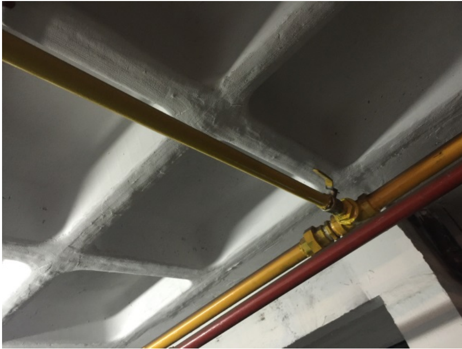
Tubulação de gás executada posterior a entrega, abaixo da padaria – área comercial
