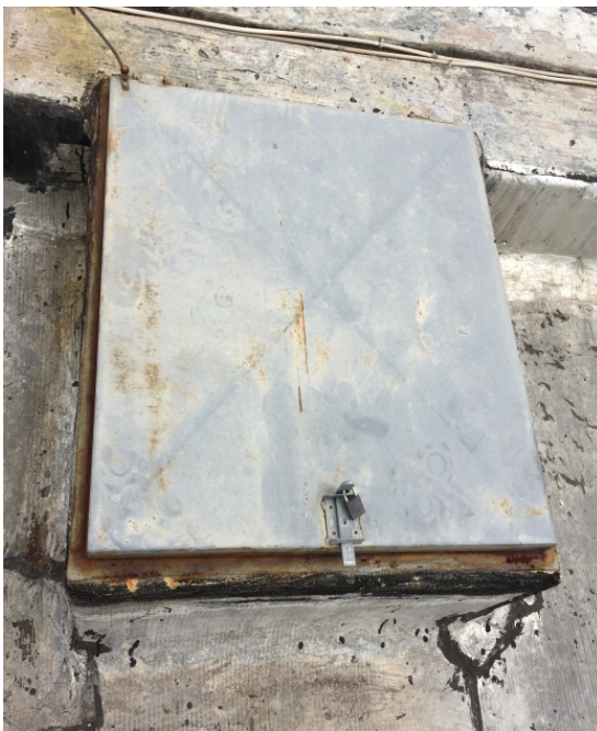
Alçapão reservatório superior enferrujado – cobertura bloco D
